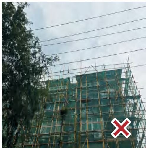
架门窗处未拉结，连墙件缺失
