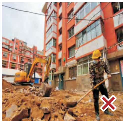
房屋拆除及清理无降尘措施
