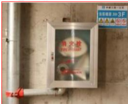
消防系统永临结合
